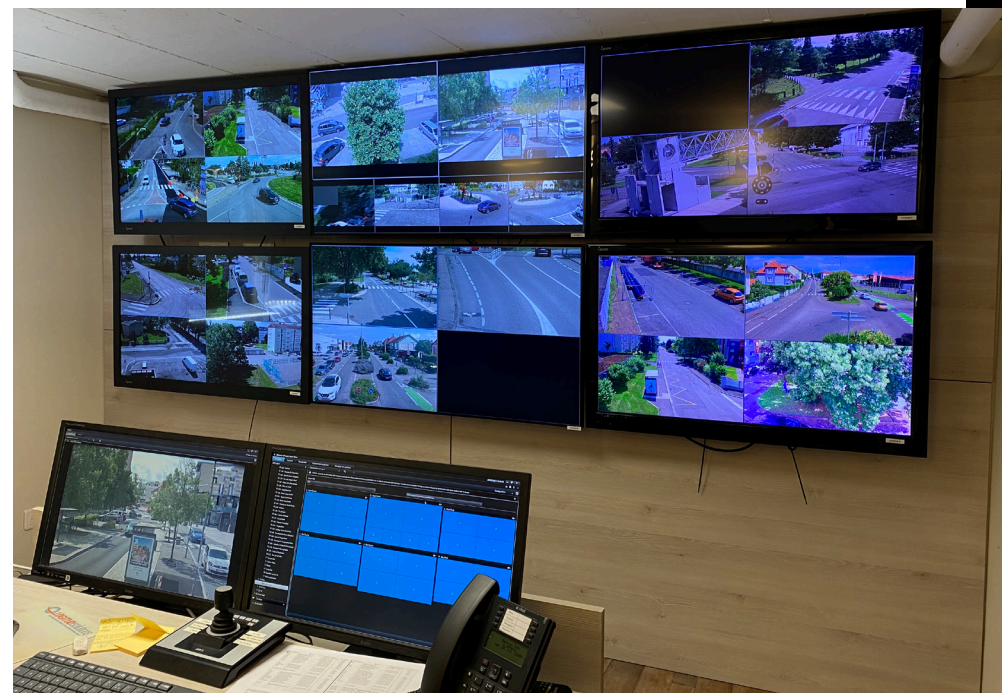
Centre de supervision de la vidéoprotection
